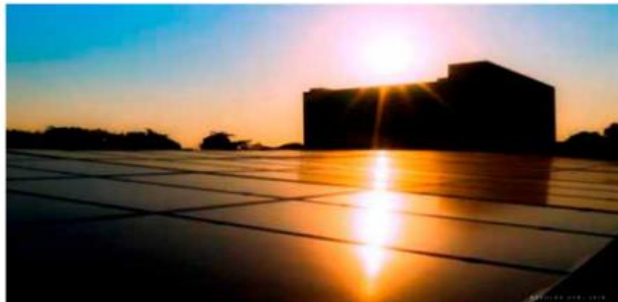
Sistema de microgeração fotovoltaica de 35 KW em restaurante universitário.
